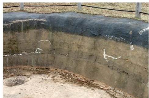
樹脂製壁面の亀裂
