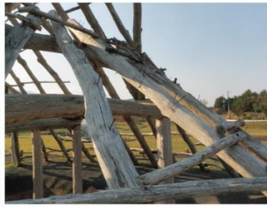
エツリの脱落
