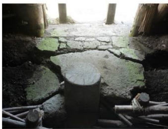
劣化した入口のモルタル
